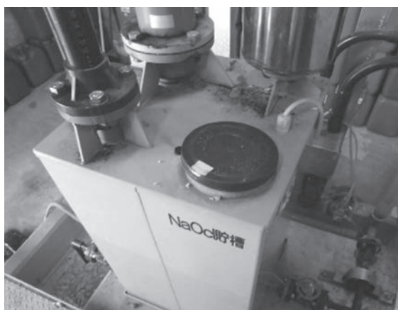
塩素貯留タンク
